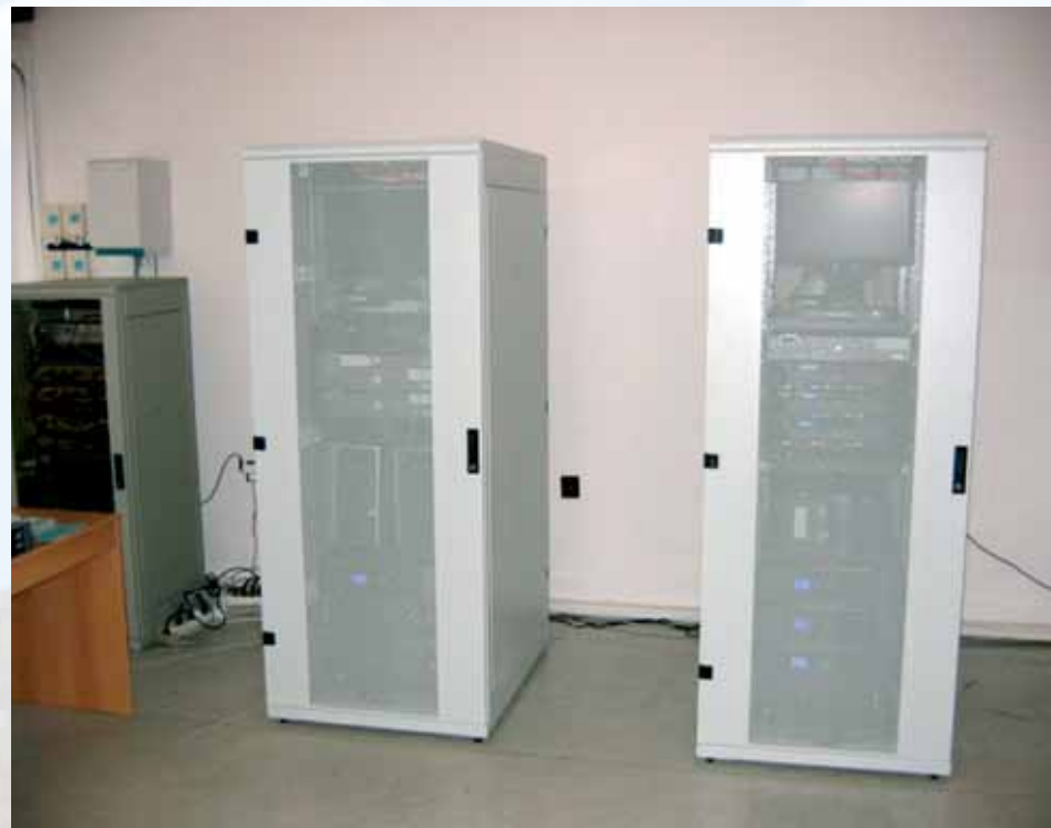
Pohľad na usporiadanie serverov v rackových zostávach
