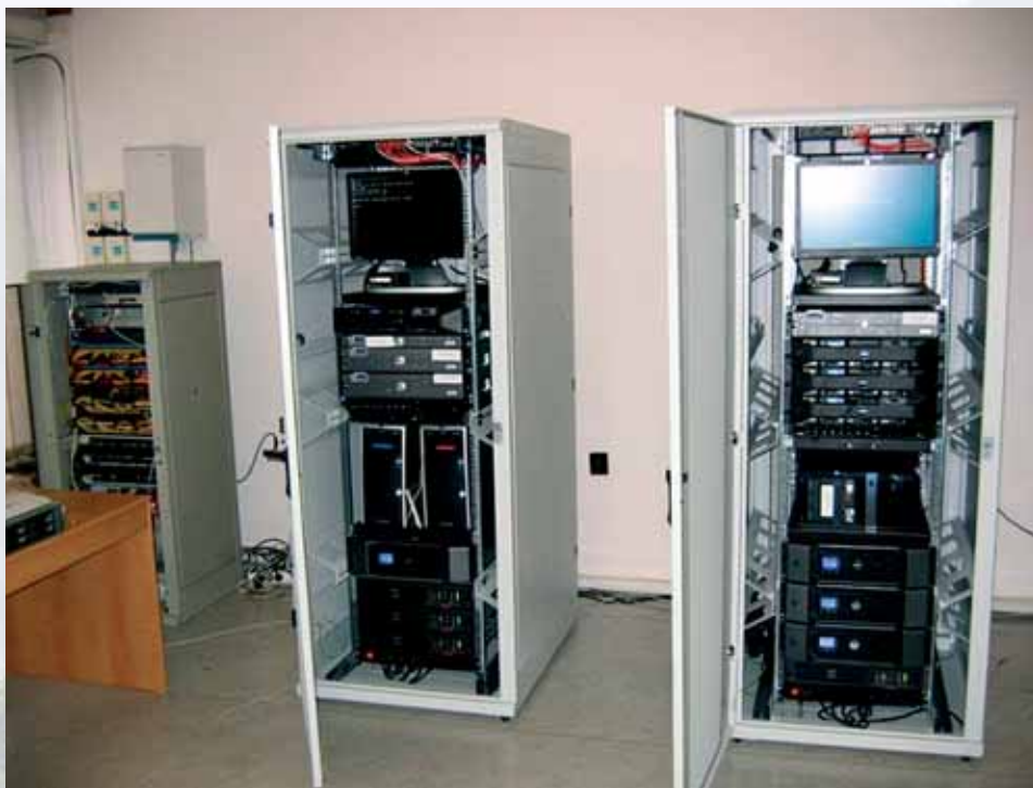
Pohľad na časť rackových zostáv
